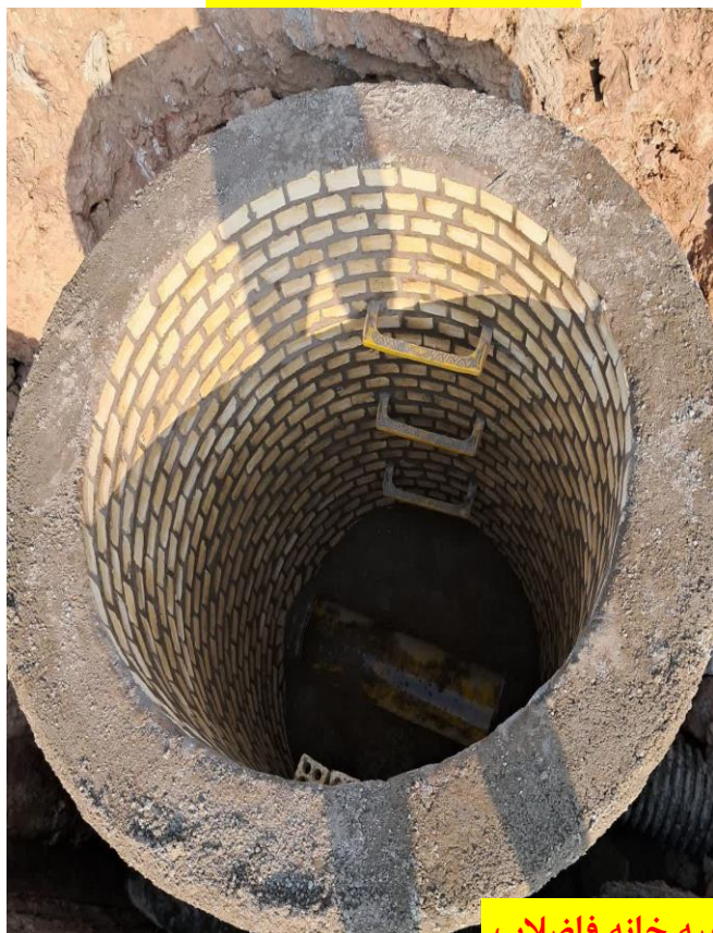
ارتقاء تصفیه خانه فاضلاب
